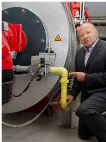
Kleiner Anschluss, große Wirkung: EMB-Key-Account-Manager Roland Knetsch deutet auf die Leitung, welche die Dampferzeugungsanlage der Mietwäsche Havel oHG mit Erdgas versorgt.
